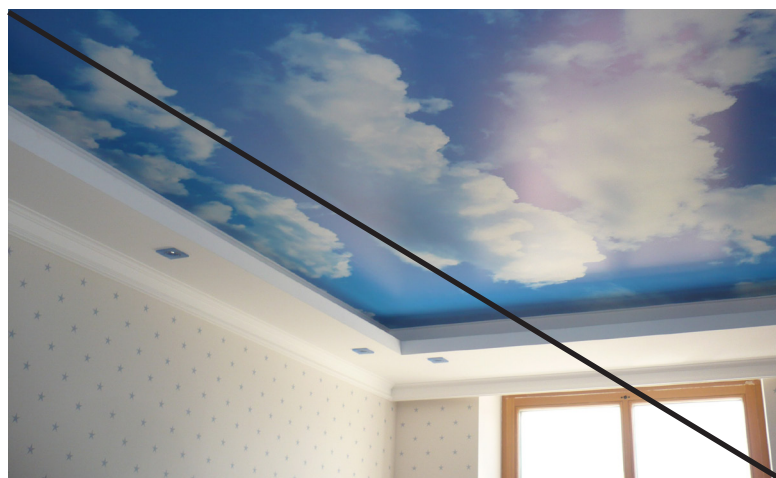
Плохо Натяжные потолки. Потолки с рисунками
